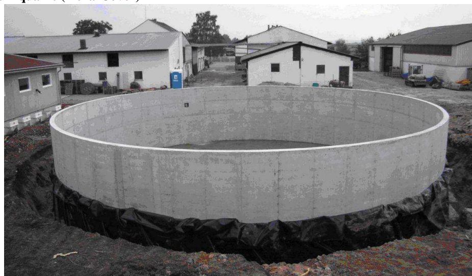
Figura 9. Vasca di stoccaggio liquame sotterrata in parte con geomembrana a tenuta di liquidi*
